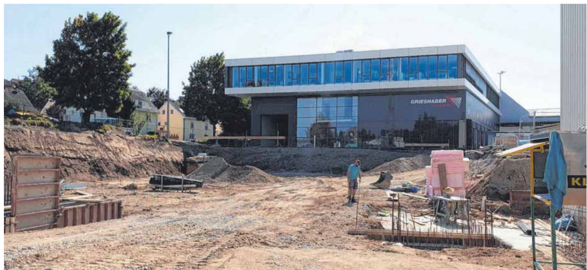
Die Grieshaber Logistik GmbH expandiert erneut und baut an ihrem Standort im Weingartener Gewerbegebiet Trauben eine neue Umschlaghalle. FOTO: GRIESHABER LOGISTIK
